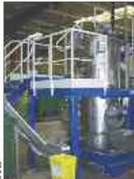
© DGS Appareil de prétraitement par désinfection
